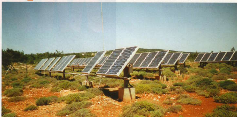
De zonnecentrale van 20 kW voorziet twee dorpen van elektriciteit.
